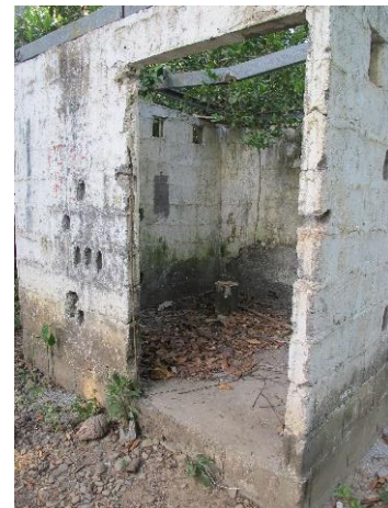
VERTEDERO IMPROVISADO No.4 – REMEDIOS, EL PORVENIR El Porvenir, Barranco atrás de un pozo de agua
