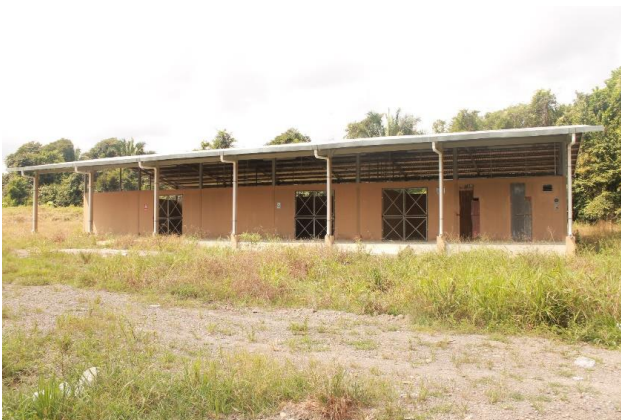
VERTEDERO DE BARU – GALERA DE RECICLAJE CLAUSURADA
